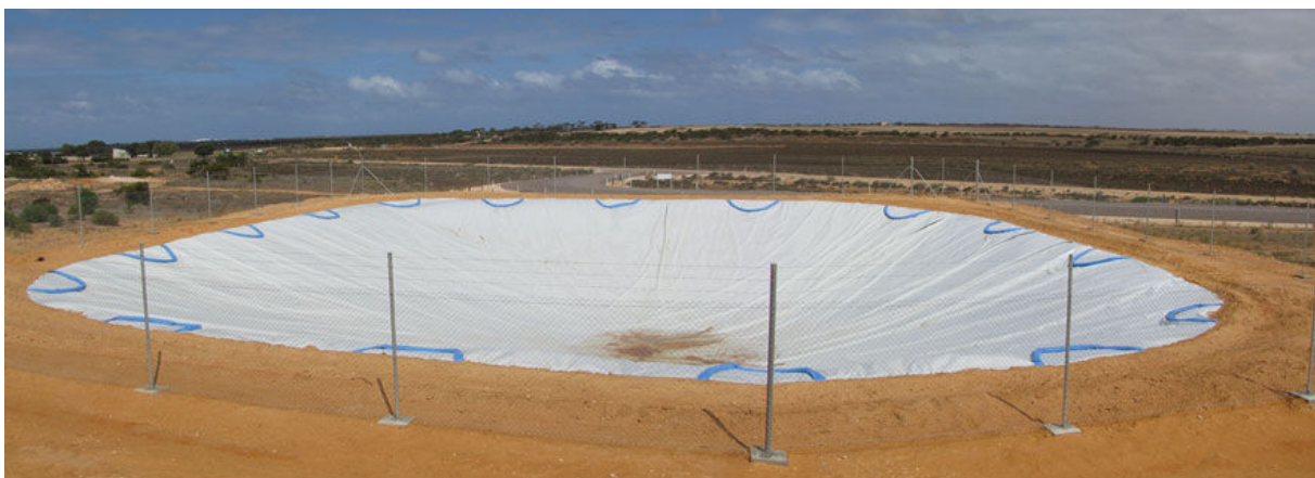
Instalación de VapourGuard por FABTECH SA PTY LTD en Arno Bay, Sur de Australia (1.800m 2 )
